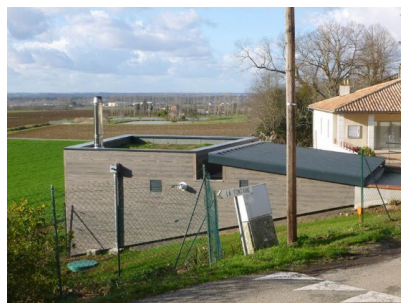
Chaudière collective bois déchiqueté Commune de Lagarrigue (Antropik Architecture)
